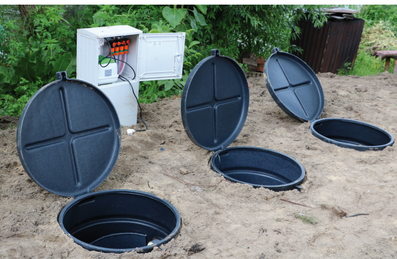
Przydomowe oczyszczalnie ścieków w Nowinach
